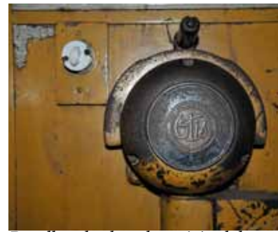
Detalhes do elevador original do Palace Hotel, o primeiro elétrico da cidade. O equipamento foi vendido na década de 1970 e ainda funciona
